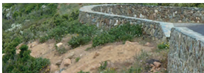
Muret / assise / sécurité
